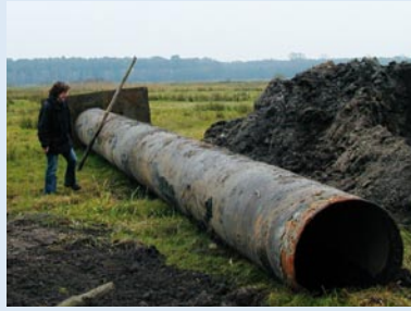
13 m langer Rohrdurchlass der ehemaligen Überfahrt – für Wasserfauna nicht durchwanderbar
