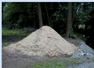
Sediment-Zugabestelle am Gewässer
