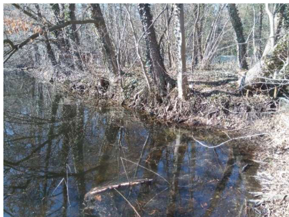
Abb. 23: freiliegende Uferböschung und Erlenwurzeln in Tongrube 2
