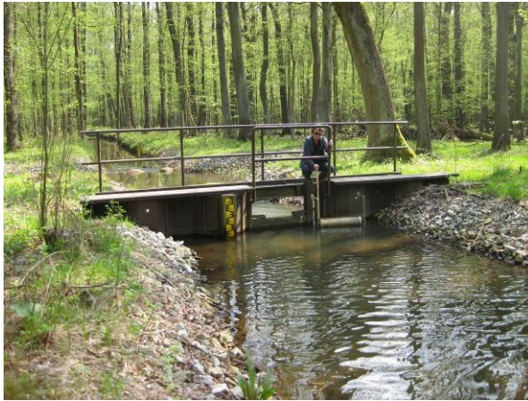
Ökologisch durchgängiges Bauwerk am Abzweig des Forstgrabens F1.2 vom Puhlstrom
