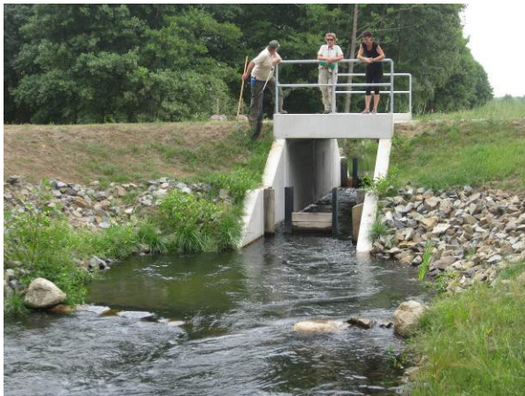
Überfahrt mit den technischen Einbauten des Fischpasses, im Unterwasser folgen 2 naturnahe Steinschwellen
