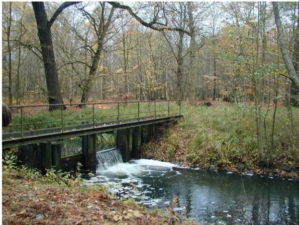
Wehr Lehmannstrom vor der Maßnahme – eine ökologische Barriere
