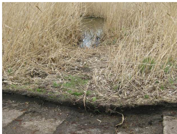
Gewässerverbindung am Mahlbusen mit nicht mehr funktionsfähigem Rohrdurchlass
