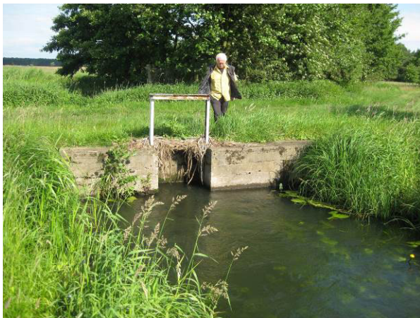
Mündungsbauwerk vor der Maßnahme – Barriere im Biotopverbund
